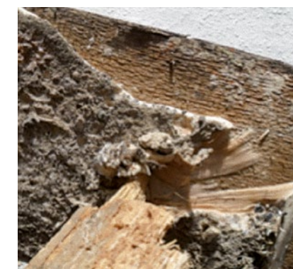
Abbildung 3 Pilzbefall unter Fußbodendielung
