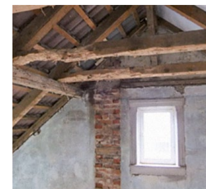
Abbildung 4 Nicht mehr tragfähige Kehlbalken durch Schädlingsbefall
