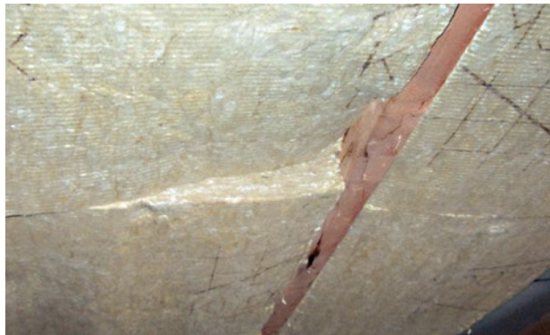
Abbildung 32 Zusammgedrückte Wärmedämmung zwischen den Sparren
