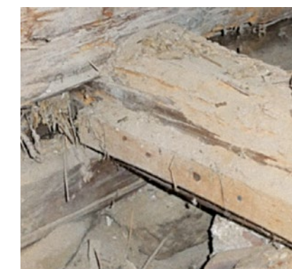
Abbildung 5 Problemstelle Auflagerbereich für Fußschwelle und Balkenköpfe
