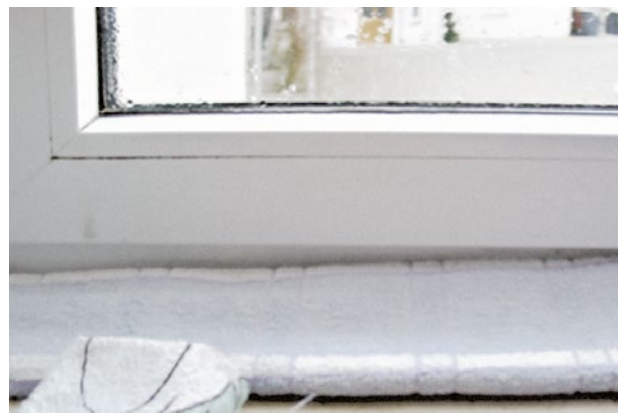
Abbildung 9 Starker Tauwasserausfall am Randverbund des Glases
