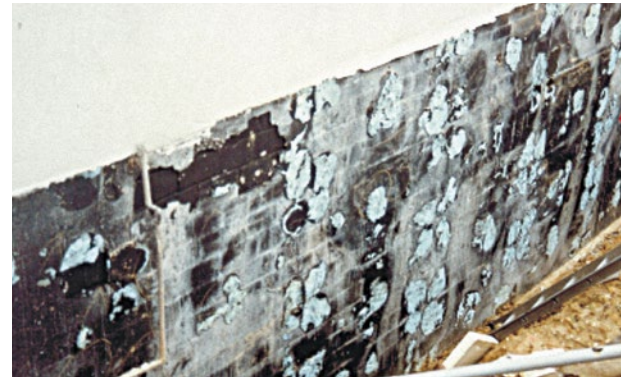
Abbildung 102 Perimeterdämmung war nicht vollflächig verklebt. Die Dämmwirkung wurde stark reduziert, da Wasser hinter die Dämmebene gelangen konnte
